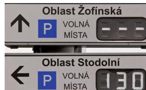
Tabule nasměrují řidiče na parkoviště s volnými místy. Information panels help drivers find vacant parking spaces.
